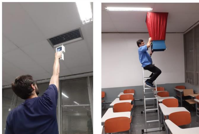
Medição da vazão de ar exterior de renovação
