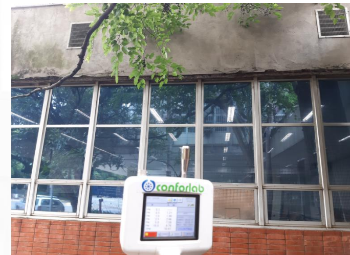
Tomada de ar externo na fachada
